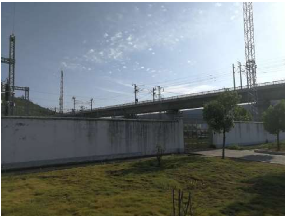
图 9.2-2 220kV 当涂东牵引变电所现状
