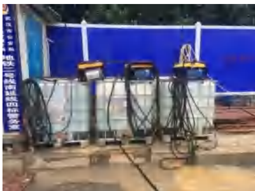
图 4.3-1 高压冲洗设施
